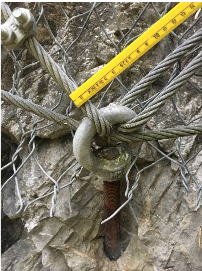
Foto 10: particolare della fune in acciaio
